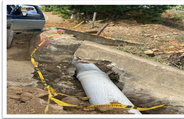
Afectación a la estructura de concreto de la obra hidráulica existente
