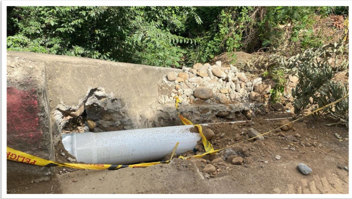
Afectación a la estructura de concreto de la obra hidráulica existente
