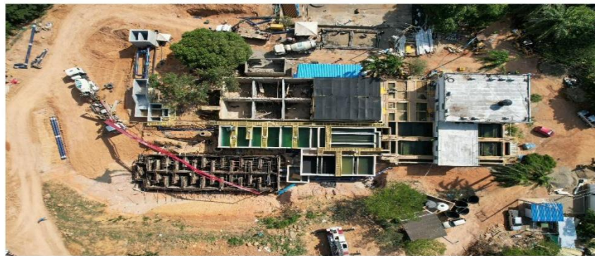
Fotografía No. 23. Sector de la PTAP donde se están ejecutando las obras.
