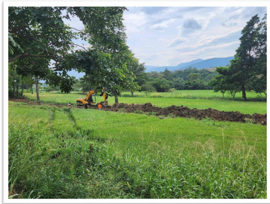
Tramo de tubería faltante de conexión al desarenador (17 de agosto de 2024)
