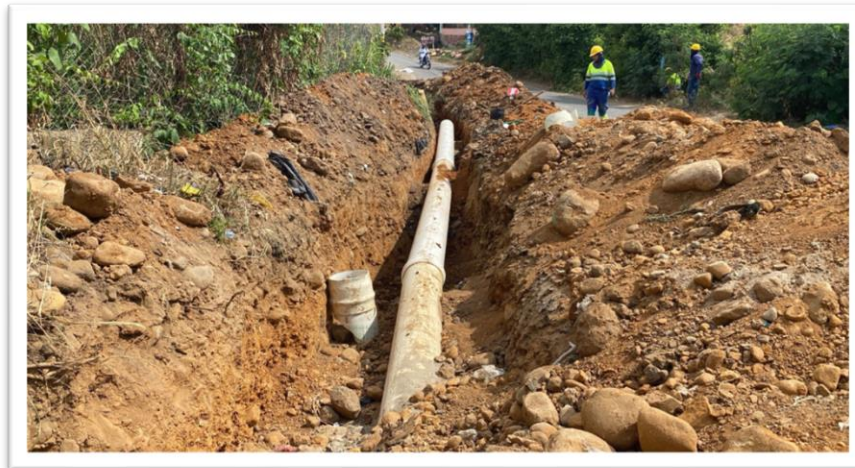
Deficiencia en la alineación horizontal de la tubería
