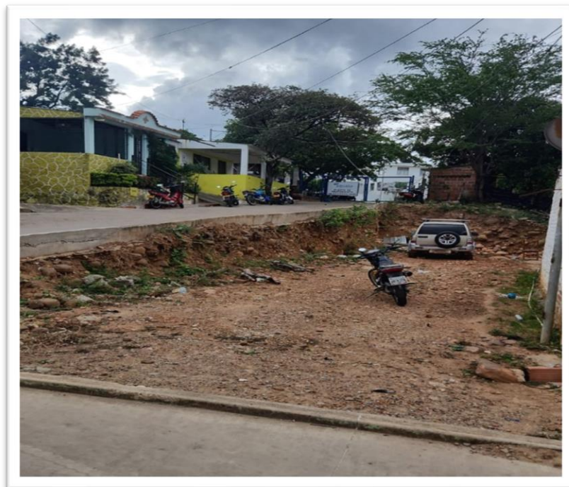
Tramo de tubería faltante de conexión a la PTAP (17 de agosto de 2024)
